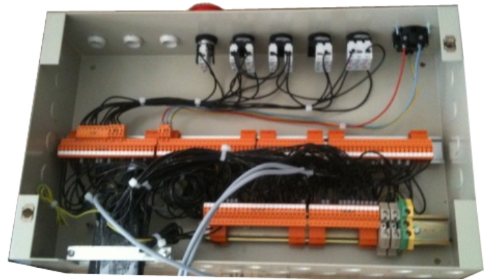
Boîte d'inspection et de raccordement
