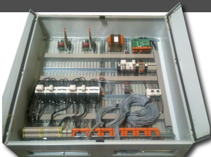
Armoire hydraulique avec pilotage de deux moteurs simultanés et deux cartes Bürcher-Beringer chantier Leroy Merlin La Valentine - Marseille
